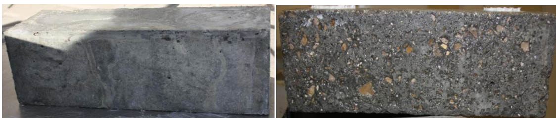
Figura 4.30 - Betão HB50RIA - No início (esquerda) e ao fim de 300 ciclos de gelo-degelo (direita).
