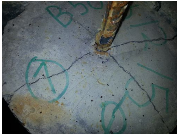
Figura 4.14 - Modo de rotura dos provetes de arrancamento
