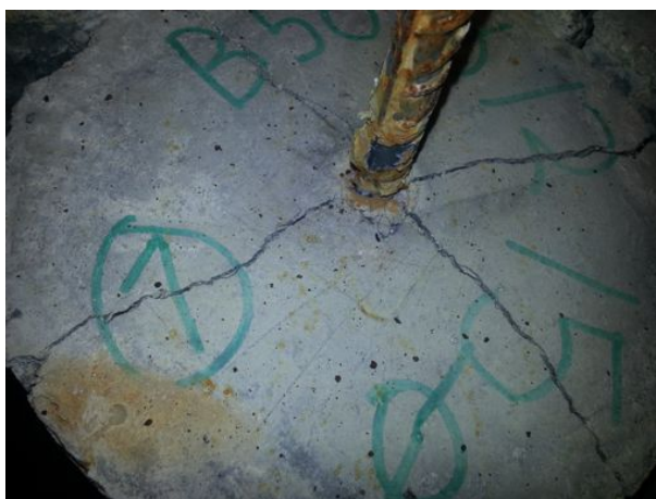
Figura 5.7 - Abertura radial de fendas no ensaio de arrancamento
